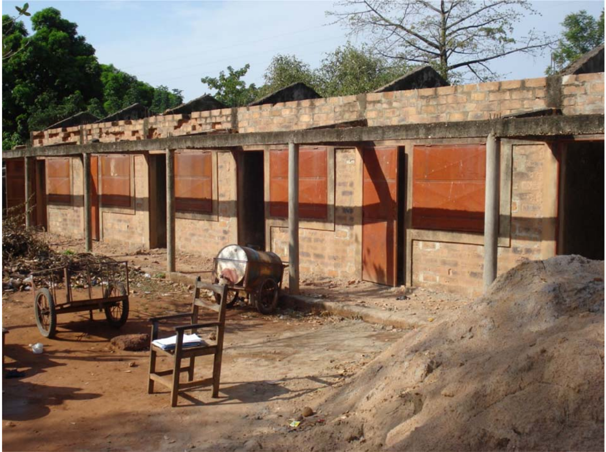
Boutiques à terminer à Banfora avec un tas d'ordures à l'extrême droit à évacuer
